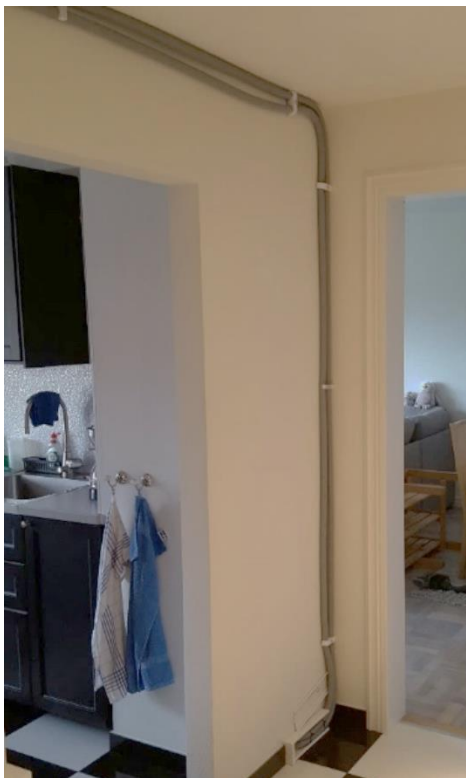
Tappvattenrör indragna från trapphus till hall i lägenhet. Rören är dragna i tak- och väggvinkel.
