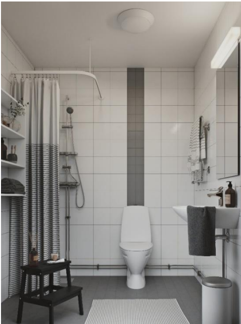
Utanpåliggande förkromade rör i badrum.
