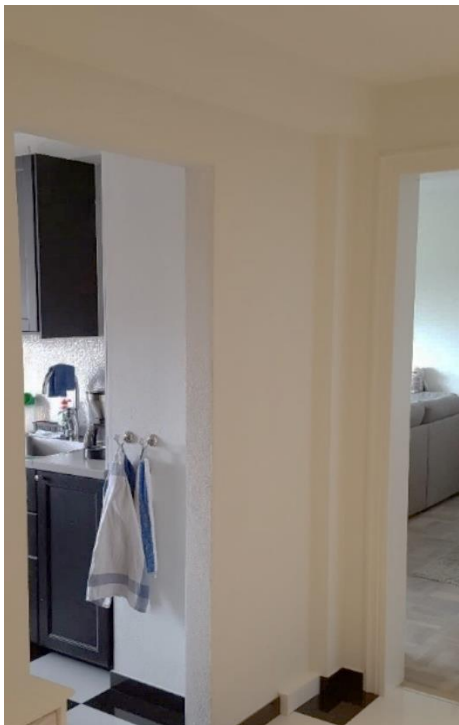
Här ser ni en platsbyggd vitmålad inklädnad av rören i föregående bild.
